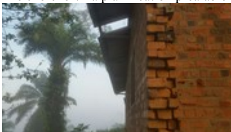
Sturmschaden am Dach
